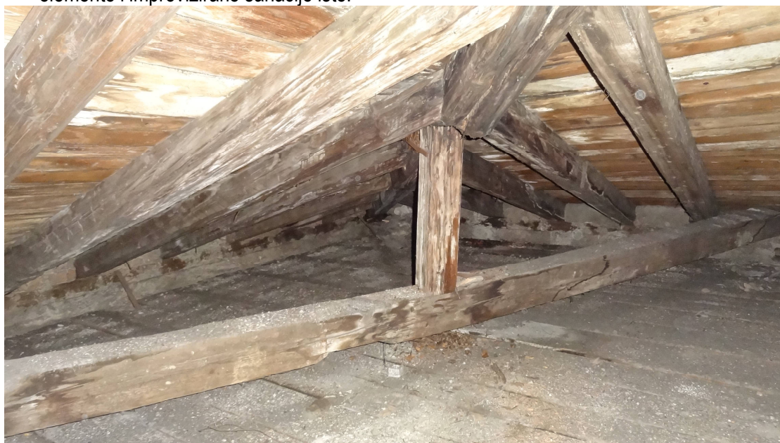
Slika br.5: Trajno oštećena grebena greda (posljedica vidljiva na slici br.3)
