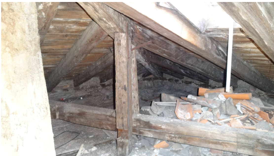
Slika br.7: Improvizirana sanacija oslonca grebene grede – poremećen statički sustav krovišta
