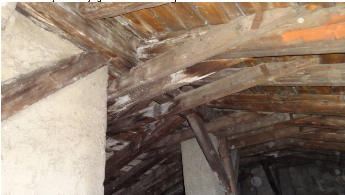
Slika br.4: Sveprisutni tragovi curenja vode kroz krovšte
