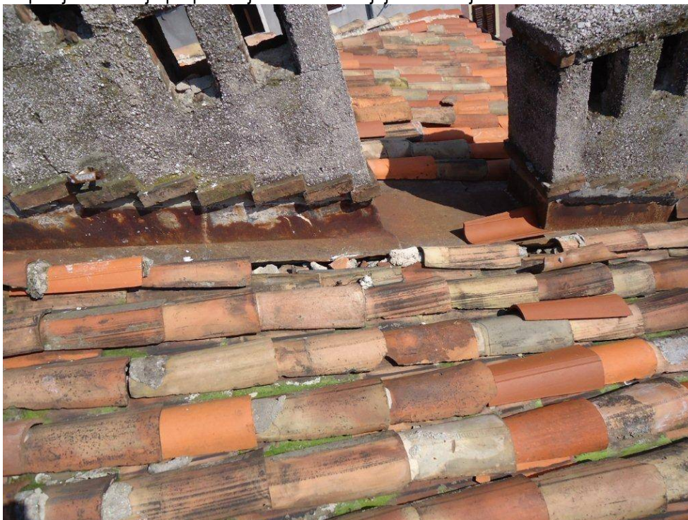
Slika br.1: Oštećenja opšavnih limova i crijepa na kontaktu s limom
