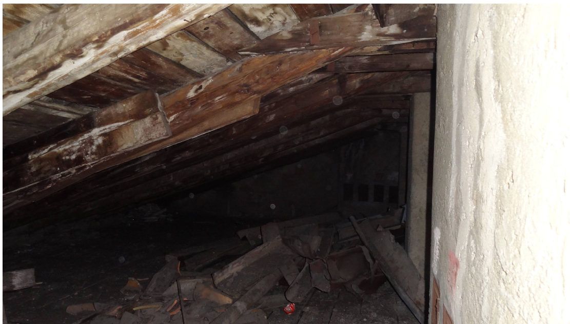
Slika br.6: Trajno oštećeni rog i improvizirana sanacija istog
