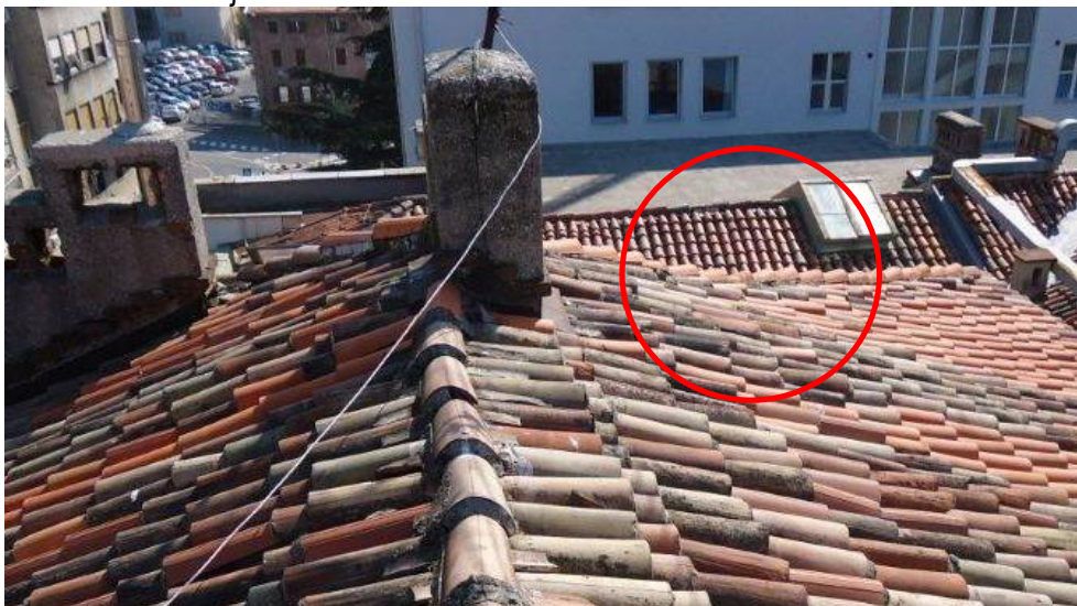
Slika br.3: Trajne deformacije krovne konstrukcije – grebeni nosač i pripadajuće strehe
