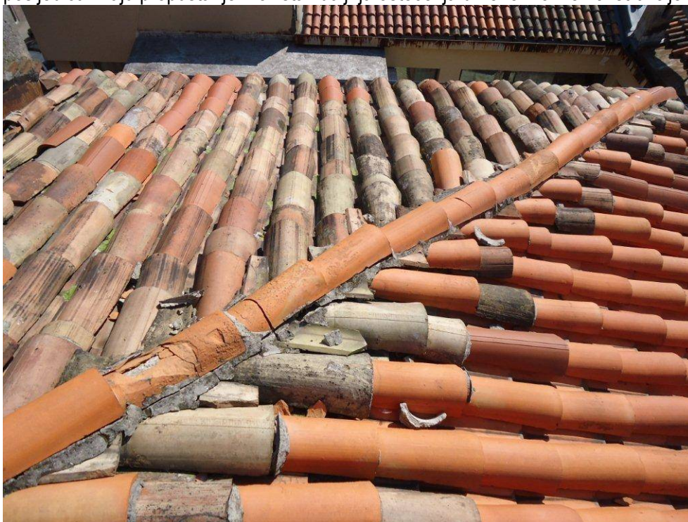
Slika br.2: Oštećenja crijeva i veznog morta
